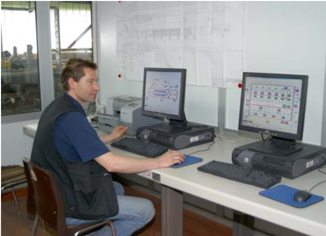
Prozessrechner für die Steuerung und Bedienung der Trockner- und Ofenanlage Process computer for the control and operation of the dryer and kiln plant
