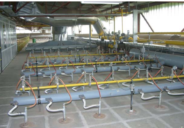
Neue obere Absaugung in der Kühlzone New upper suction in the cooling zone
