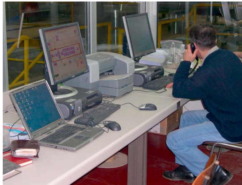
In der Schaltwarte sind die Prozessrechner für Trockner und Ofen aufgestellt
