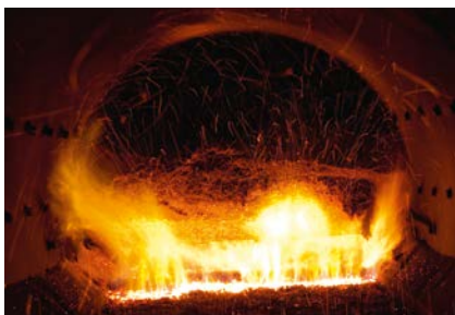
Planta de incineración
