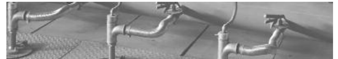
Deckenbrenneranlage auf Tunnelofen
