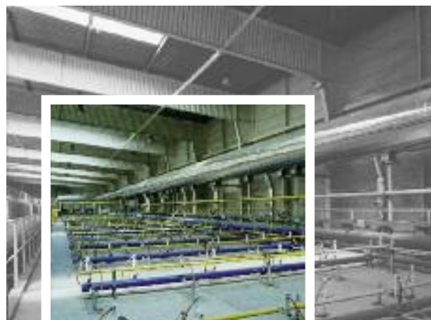
Brûleur du plafond
