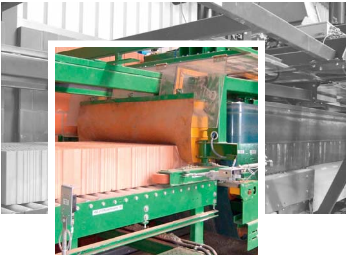
Einlauf Verfüllstation Mineralgranulat
