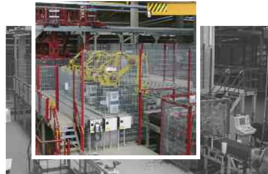
Nassseite bestehend aus: Abschneideeinrichtung, Trockenpalettenbeladung, Trocknerwagenbeladung und Palettenspeicher
