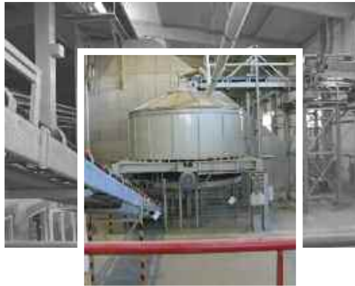
Kollergang im Bereich der Materialaufbereitung
