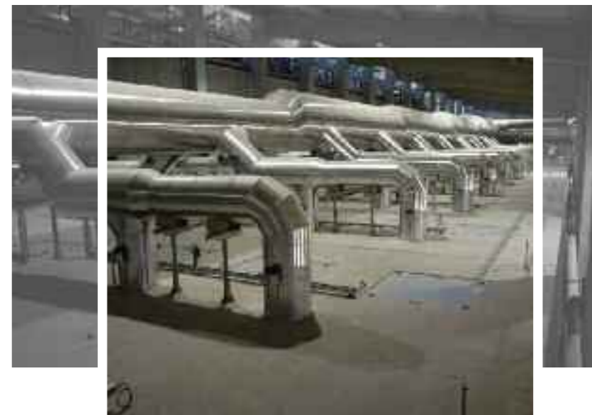
Warmluftleitung mit Verteilleitungen zu den Axialventilatoren Hot air duct with distribution lines to the axial fans
