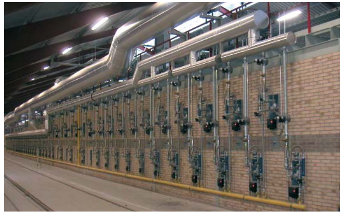
Bild 4: Seitenbrenneranlage mit Hochgeschwindigkeitsbrennern Fig. 4: Side burner plant with high-velocity burners
