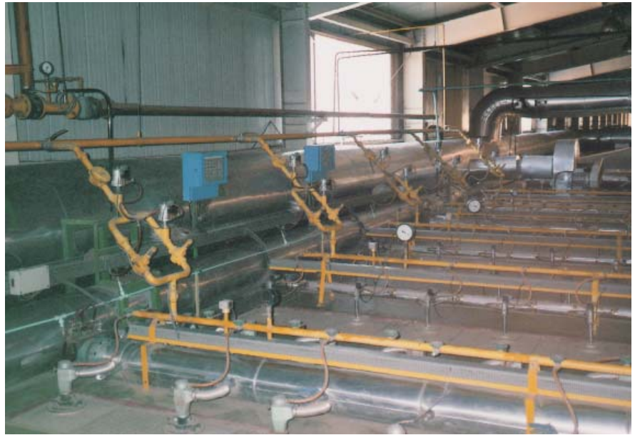
Система газовых горелок на тоннельной печи
